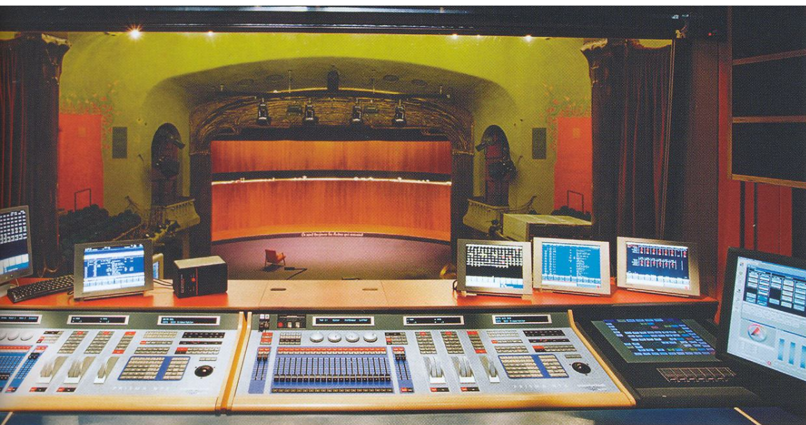
379. Münchner Kammerspiele. "Световая" комната. Сдвоенный пульт управления Transtechnik Prisma NTX на основе Linux. Максимум 16384 канала управления (традиционные прожекторы, скроллеры и приборы типа "moving light"). Протоколы AVAB, ETCNet2 и ArtNet. Transtechnik Digiplus для рабочего и репетиционного освещения. Сенсорная панель 19" Transtechnik Libra (конфигурируемый пользователем графический настольный ПК для NT/NTX) и управление узловыми сетевыми устройствами SNMP
